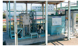
西鳥取車両支部の排水処理装置の老朽取り替えにおいて、環境に配慮した検討を行い、エネルギー消費量が少ない電解処理方式を採用しました。
